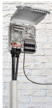
Câble de branchement qui sort du PBO
