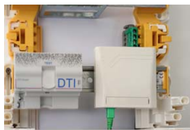
Coffret de communication
